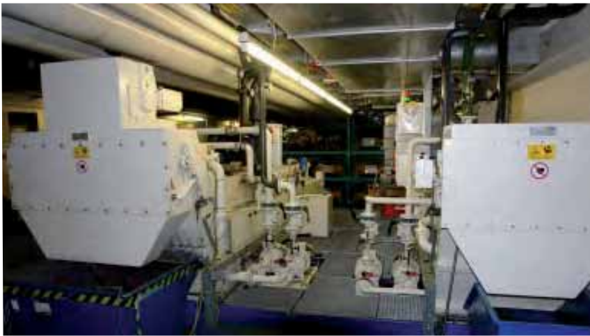
Zwei MAF für die Versorgung einer kompletten Fertigungslinie zur Herstellung von Säulen, Rundführungen und Kolbenstangen.
